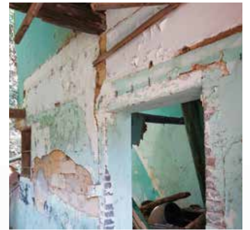
從剝落的牆身窺探到，此房屋的門框以青磚建造，牆身以土磚築砌。
