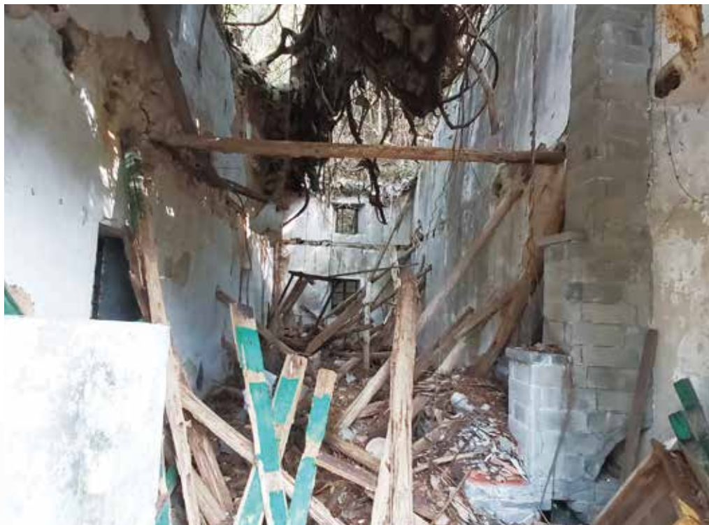
村屋被入侵性植物纏繞，內部被樹枝壓毀屋頂，復修工程並不簡單。
